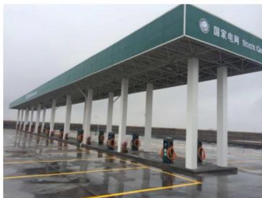
图 5-5 国家电网公共充电站
